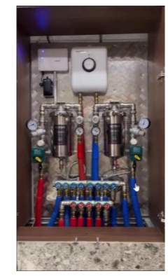
- инженерная система водоснабжения за инсталляцией в шкафу
